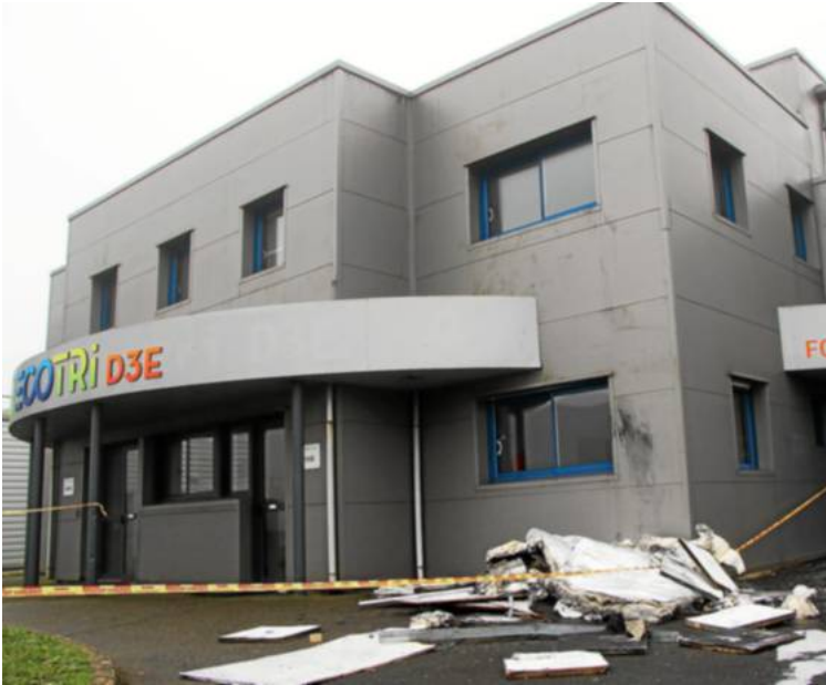
Le site a pu rouvrir partiellement, après un arrêt total imposé par l'important incendie qui avait touché le bâtiment en février. Photo d'archives Le Télégramme
